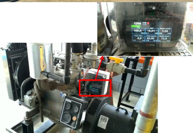
Gerador em funcionamento
