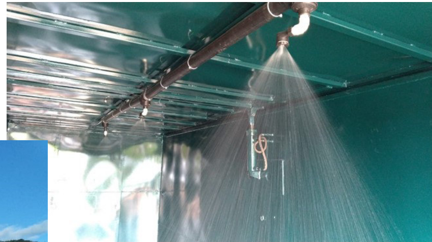
Aspersores de lixiviado
