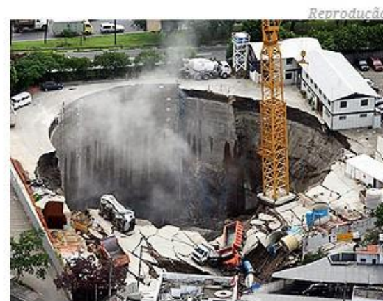
Desabamento ocorreu no dia 12 de janeiro de 2007, matando sete pessoas.
