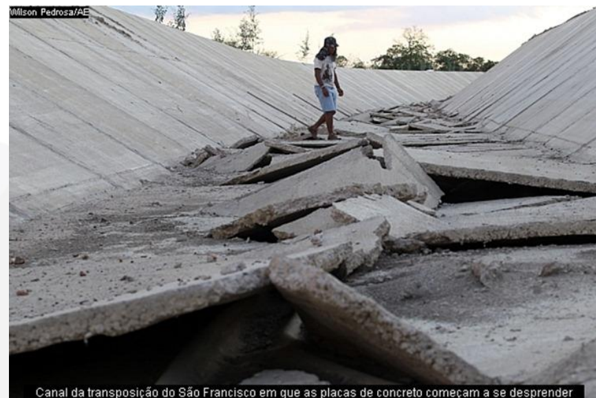
Canal da transposição do São Francisco em que as placas de concreto começam a se desprender
