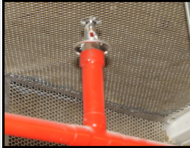
Sprinkler pendente instalado como em pé
