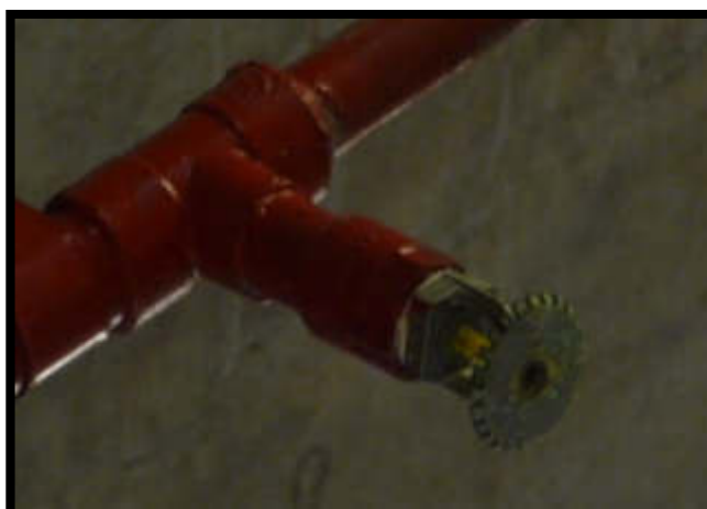
Sprinkler em pé instalado pendente
