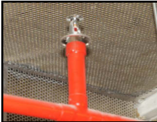
Sprinkler pendente instalado em pé
