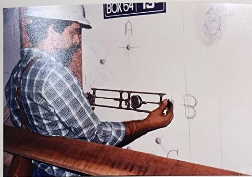
FOTO 9 - Base tridirecional para alongâmetro - instalada na base de um dos pilares do Edifício Segurasil
