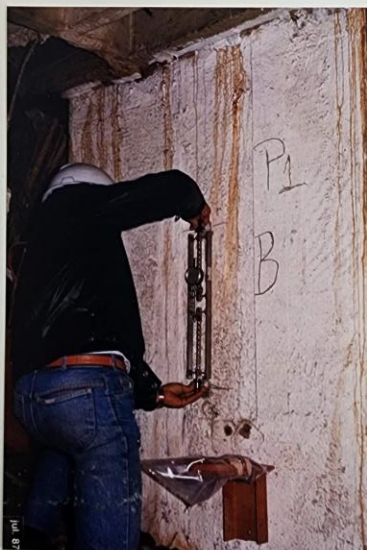
FOTO 6 - Leitura dos instrumentos instalados em um dos pilares do Sede 2B, subsolo inferior. Alongamento.
