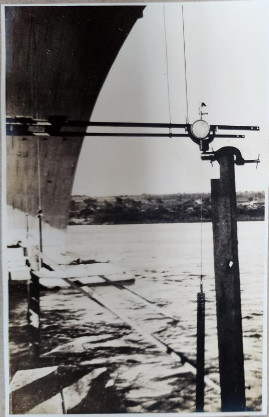
Defletômetro instalado no fêcho da abóbada 5
