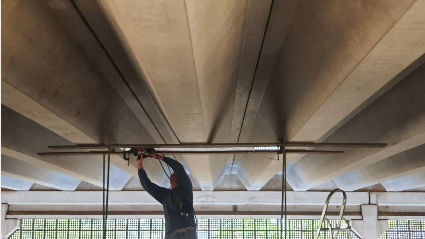
Figura 2 – Aquisição de dados de radar com antena apoiada sobre a placa de teflon montada na parte inferior do telhado.
