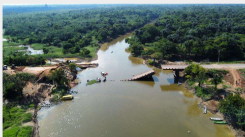
Figura 01 – Foto da Ponte Colapsada
