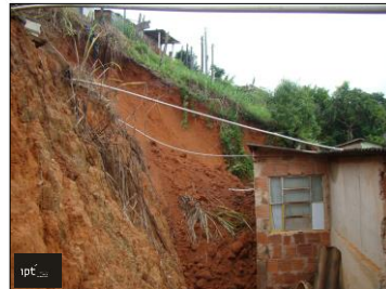
■ Cicatriz de escorregamento
