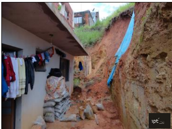
■ Cicatriz de escorregamento
