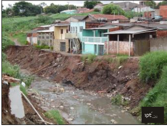
■ Solapamento de margem
