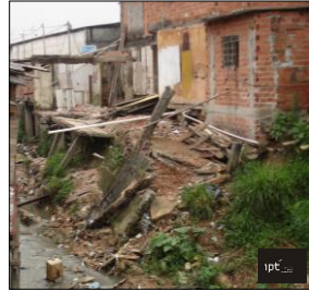
■ Solapamento de margem
