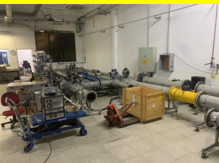
Laboratório de Vazão de Gás Natural
