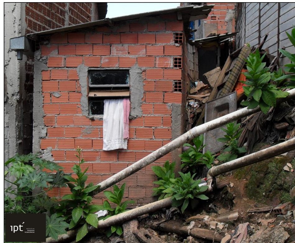
● Vazamento de tubulação
