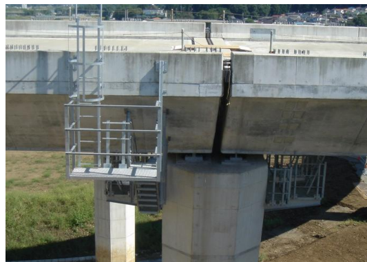
Passarela metálica instalada na região próxima as juntas de dilatação e aparelhos de apoio da OAE
